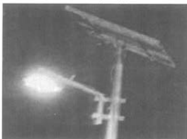
Fig. 8 : Solar street light
